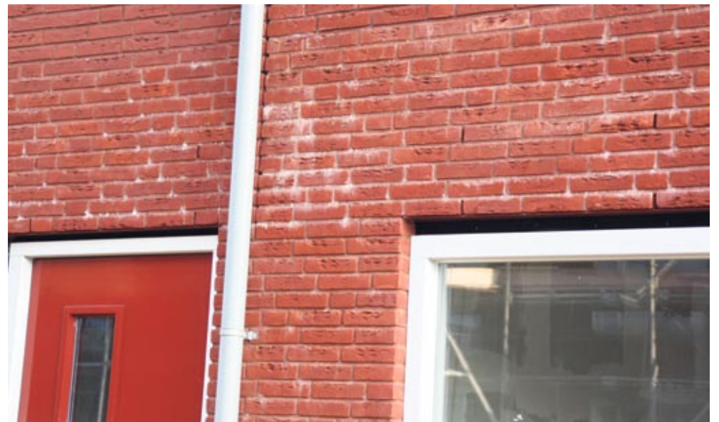
Het metselwerk van de grondgebonden woningen in het project Lingeveste is in dezelfde periode uitgevoerd met gewone doorstrijkmortel: helaas zien we hier veel witte uitslag op de gevel.
